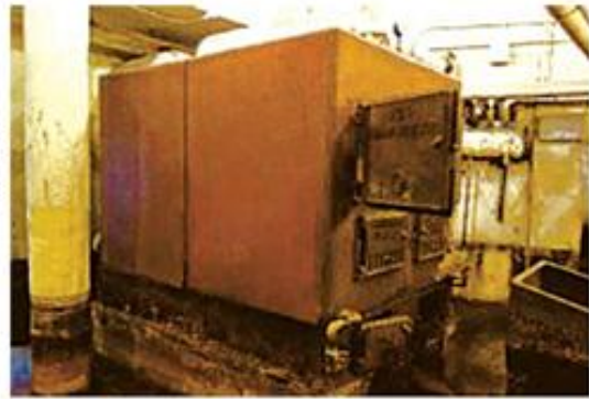
鑄鉄製ボイラー
