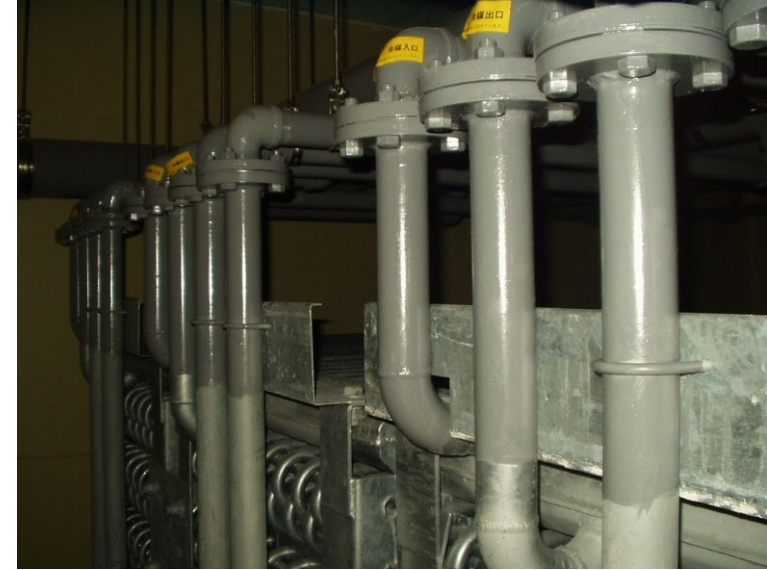
コイル接続配管
