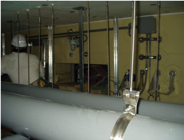
ピット内配管①
