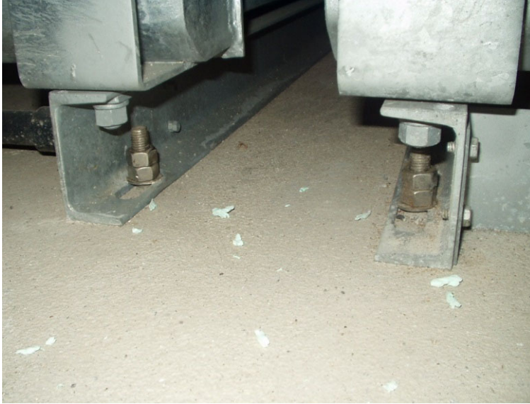
コイル下部(アンカー固定)
