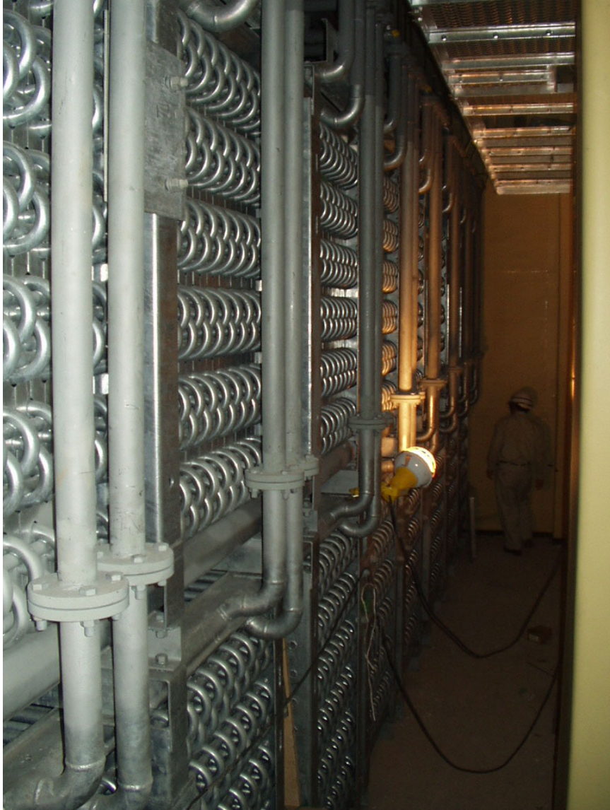
ピット内のコイル配置の様子
