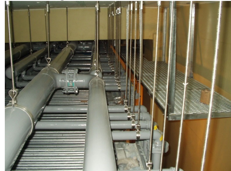
ピット内配管②
