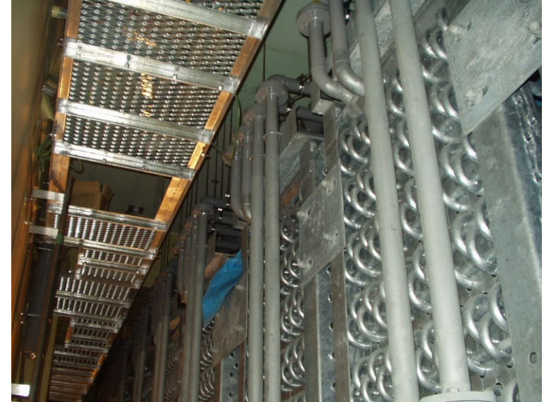
ピット内のコイル配置の様子(コイルと点検歩廊)
