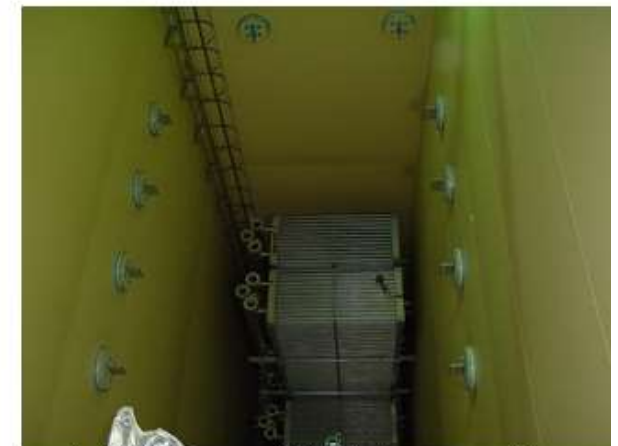
氷蓄熱コイル蓄熱槽内設置の様子
