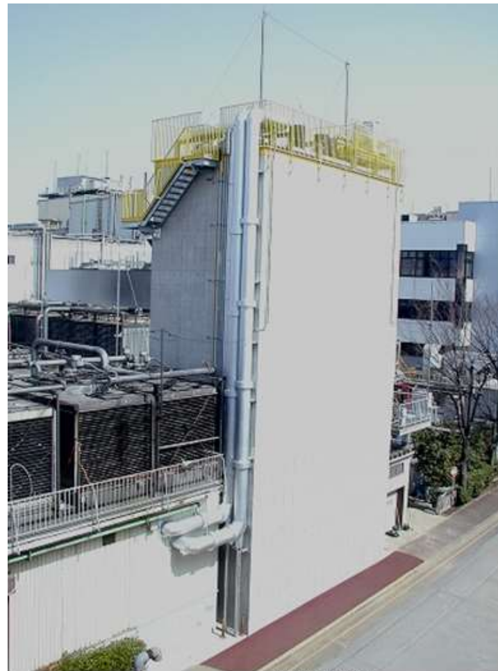
コンクリート蓄熱槽外観
