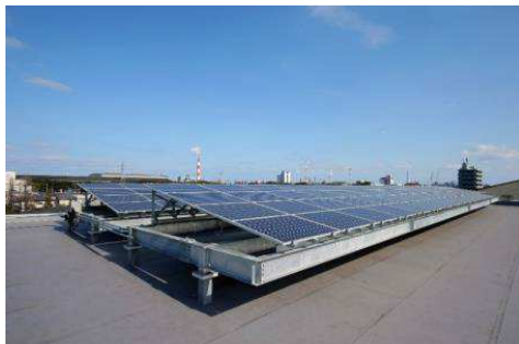
写真-5 太陽光設置状況
