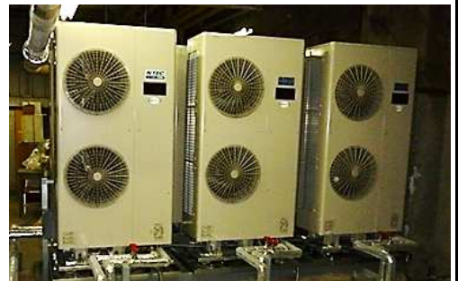
図6.ヒートポンプ式給湯機の機械室内設置
