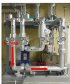
ロードヒーティング設備
