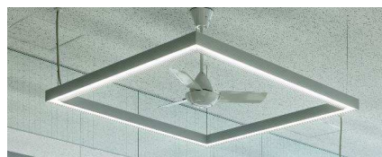
執務室LED照明とシーリングファン写真
