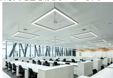
1階執務室のLED照明写真
