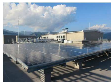
■太陽光発電設備の設置写真
