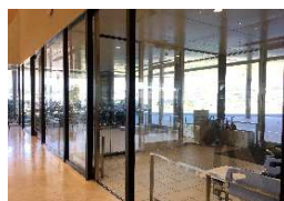
写真1. クランク二重風除室
