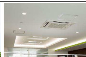
図4 空調吹き出し口
