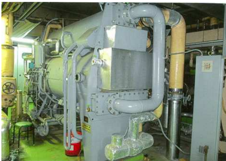
ガス吸収冷暖房機 設置状況
