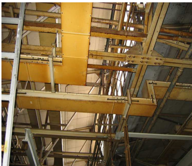
空気絶縁型バスダクトの絶縁ホルダー
