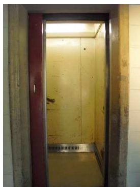
公団設置第 1 号昇降機
