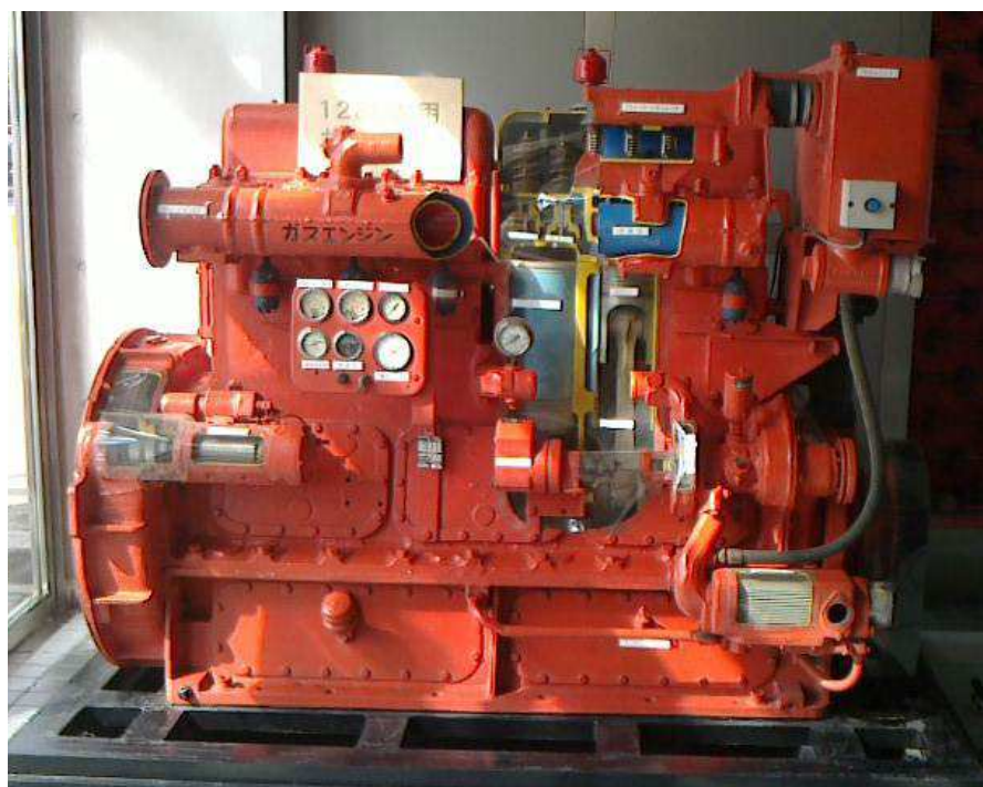
天然ガスを利用したガスコージェネレーションシステム 第 1 号機
