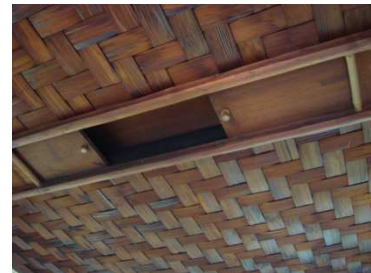
縁側天井排気口
