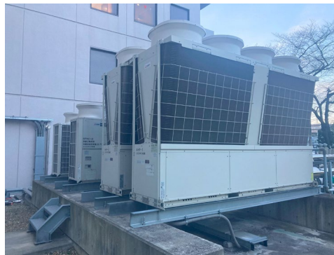
蓄熱用熱源機の地上設置 (既設は屋上設置・開放回路)
