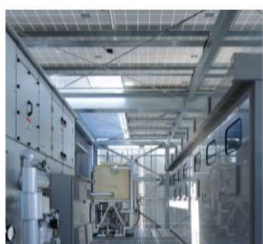
設備置場から見た屋上設置のPV
