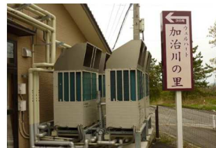
写真-1 室外機設置状況
