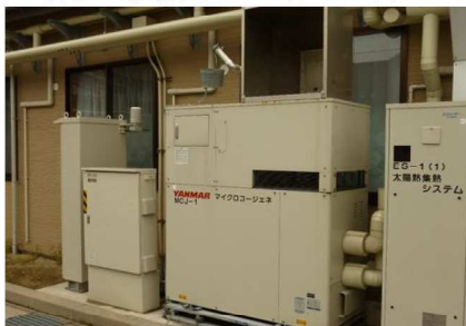
写真-2 コージェネ設置状況
