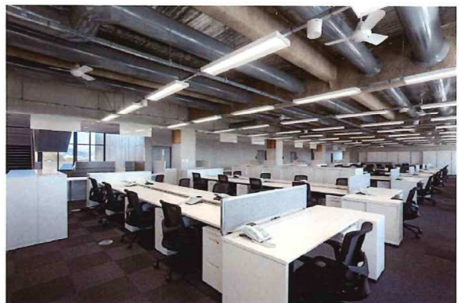
写真5 シーリングファン（天井に吊るされた3枚羽根のファン。執務エリアの各スパン2カ所に配置されている。）
