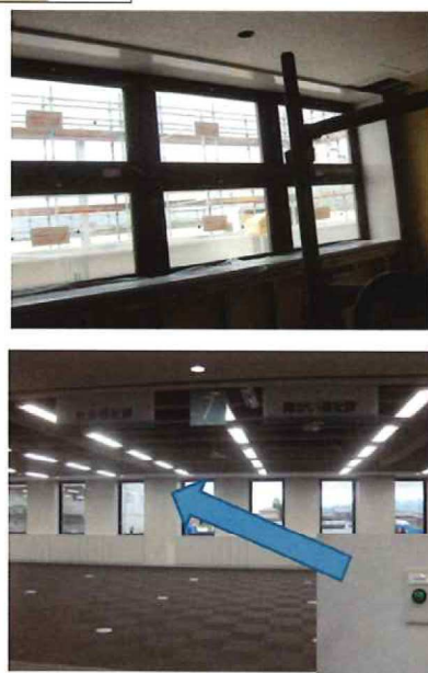
写真9 上：自然換気を促進する吹き抜け上部東側の自動開閉換気開口窓、下：事務室と窓側に取り付けた自然換気有効表示ランプ
