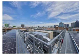
図1-2 屋上の太陽光パネル
