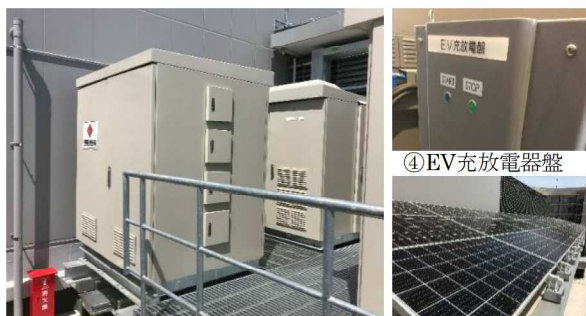
手前：③蓄電池盤 奥：②PCS盤 ④EV充電器盤 ⑤太陽光発電
