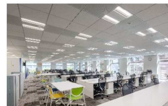
写真4 DC照明点灯状況
