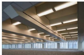
建築と一体化した梁型ダクトによる空調と明るさ感を高める照明
