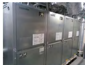
図8.地中熱HPモジュール
