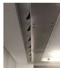
写真3 段ボールダクト
