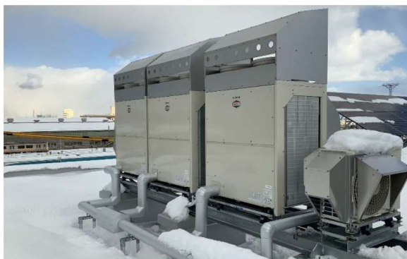
図3. ビル用マルチエアコン室外機
