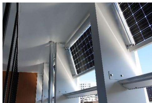
壁面PVとライトシェルフ
