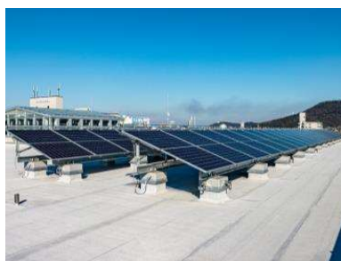
写真-10. 太陽光発電パネル
