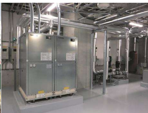
写真-8. 地中熱ヒートポンプおよび機器設備
