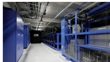
写真-11 Hydro Q-BiC外観写真
