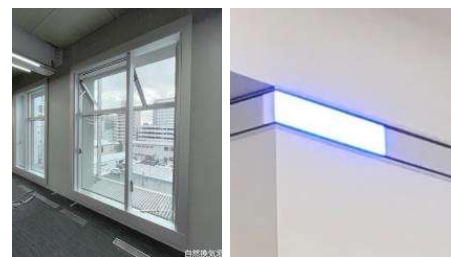
図-12 自然換気窓と誘導ランプ
