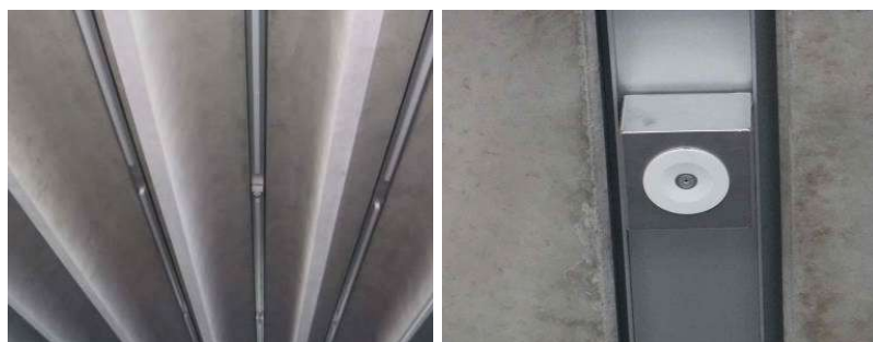
写真-10. PC天井部に設置された赤外線アレイセンサー
