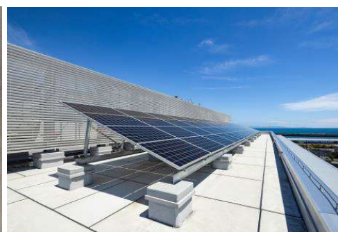
写真-7. 屋上に設置した太陽光パネル
