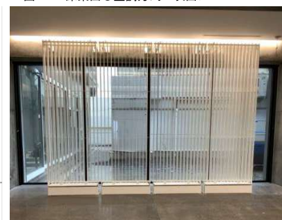
写真-11. 除湿型放射冷暖房パネル（海街ホール）
