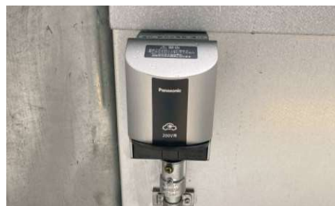
写真-14. 電気自動車充電コンセント
