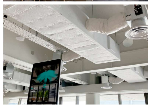
個別制御VAVの気流可視化（AR技術）によるショールームの利用
