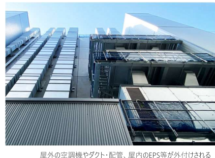
屋外の空調機やダクト・配管、屋内のEPS等が外付けされる
