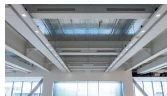
シームレスかつエッジの効いたダクト形状が軽快な天井
