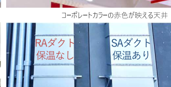
保温内貼りにラッキングなく意匠性も高い
