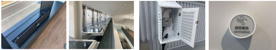
図-6 外気取入口 図-7 自然排気口 図-8 屋上センサー 図-9 有効性表示ランプ
