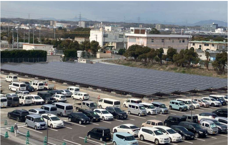
図-14 太陽光発電設備
