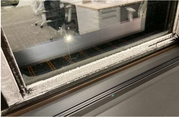
写真4-1 結露・凍結状況
