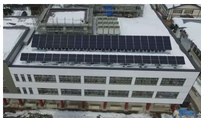
写真14 太陽光発電の設置状況 上：240W×76枚（4段19列） 下：240W×40枚（2段20列）
