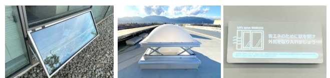
自然換気窓・トップライト兼用換気窓・許可表示ランプ
