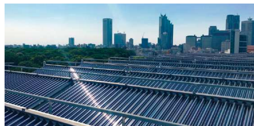
屋上に設置した太陽熱温水器
