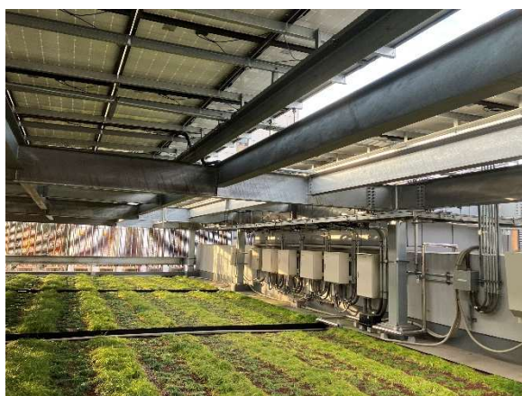
写真 3.6.3.2 屋上緑化＋太陽光パネル
