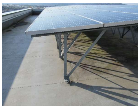
写真 3.2.3.2 太陽光発電設備
