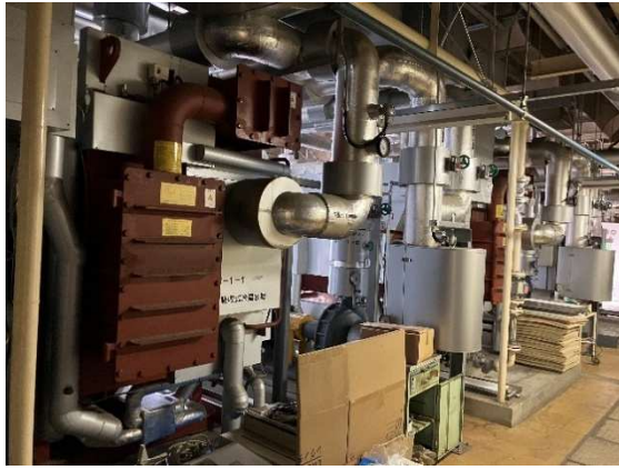
写真 3.1.3.6 吸収冷温水機
