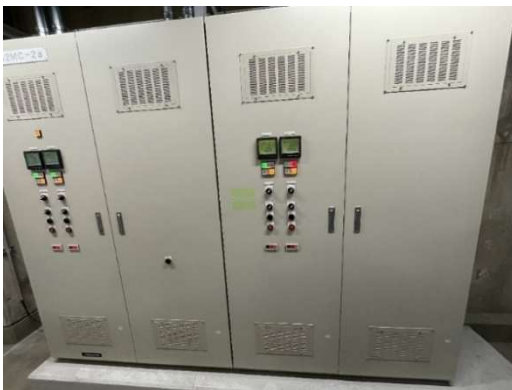
写真 3.3.4.3 改修後の熱源機械室の動力制御盤
