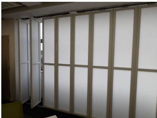
写真 3.5.4.1 日射追従ルーバー (撮影のため一部のみ手動で開放した状態)
