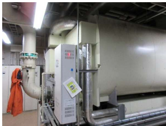
写真 3.2.3.4 ガス焚吸収式冷温水機
