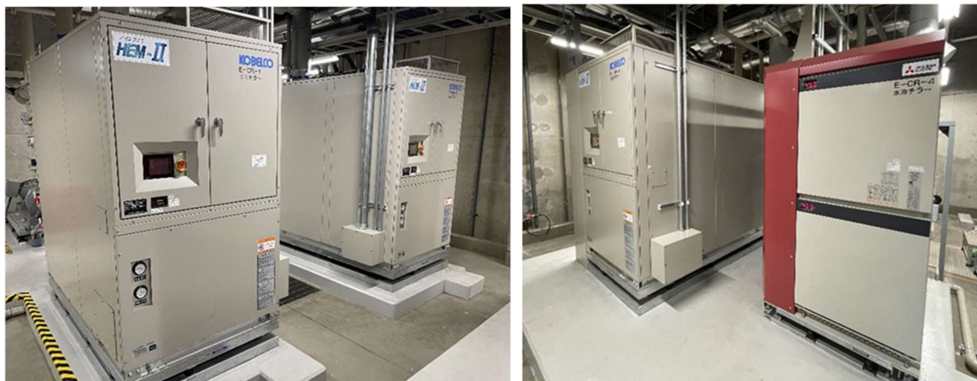
写真 3.3.4.1 ダウンサイジングした水冷チラー設置状況
