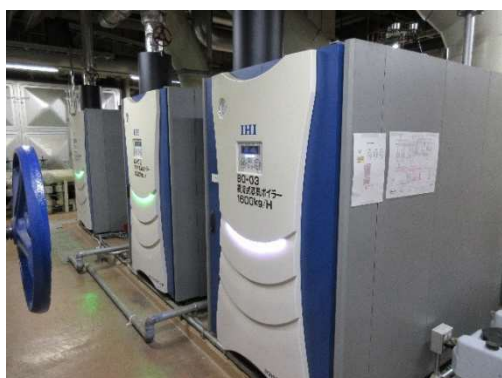
写真 3.2.3.5 貫流ボイラー
