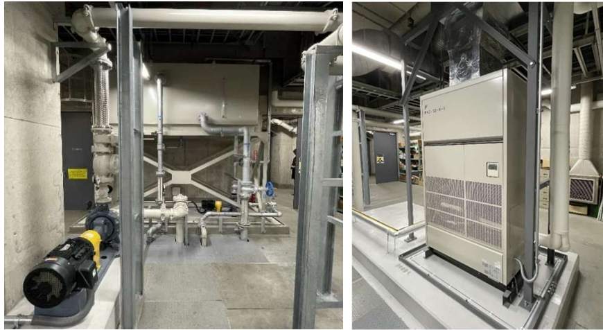
写真 3.3.4.9 非常用発電機室のオイルサービスタンクとエアコンの設置状況
