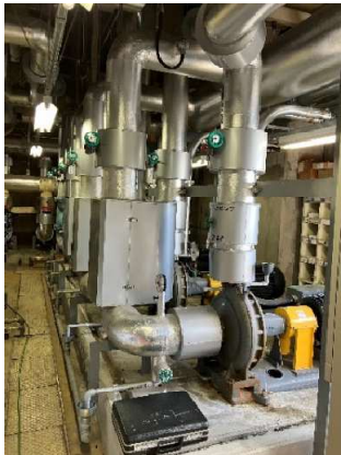
写真 3.1.3.8 1次ポンプ及び冷却水ポンプ
