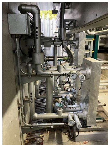
写真 3.6.3.3 地中熱利用（免震ピット内）
