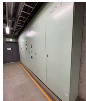
写真 3.3.4.4 熱源機械室の自動制御盤 (内部のみ改修)
