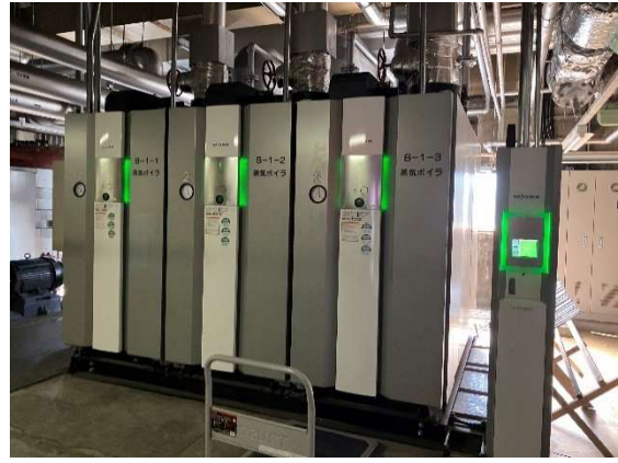
写真 3.1.3.7 小型貫流ボイラー
